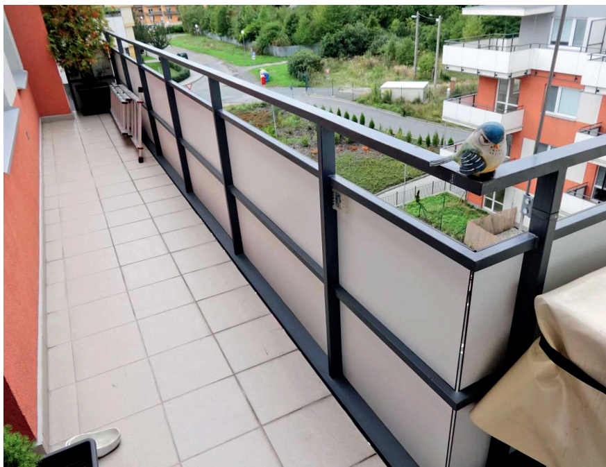
Ilustrační foto – nebezpečné zábradlí s vodorovnými prvky
